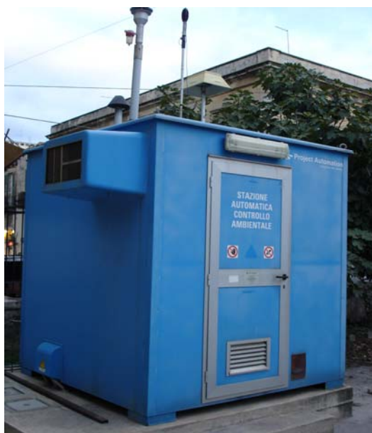
Foto 2.1.1 Stazione Automatica Controllo Ambientale
